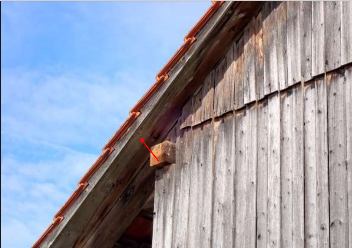
Abbildung 9: Spalten hinter einer Holzverkleidung (roter Pfeil).
