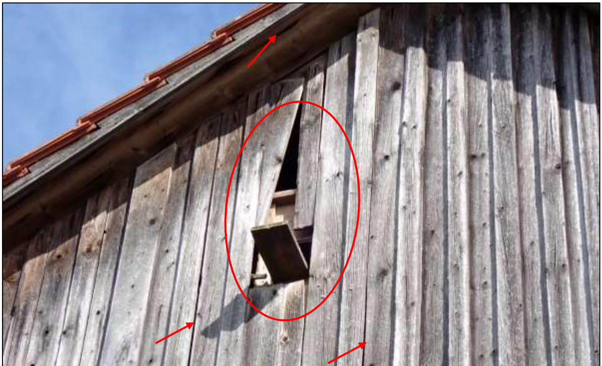
Abbildung 8: Nisthilfe für Schleiereule bzw. Turmfalke mit darüberliegender Öffnung (rote Ellipse) und Spaltenöffnungen (rote Pfeile).
